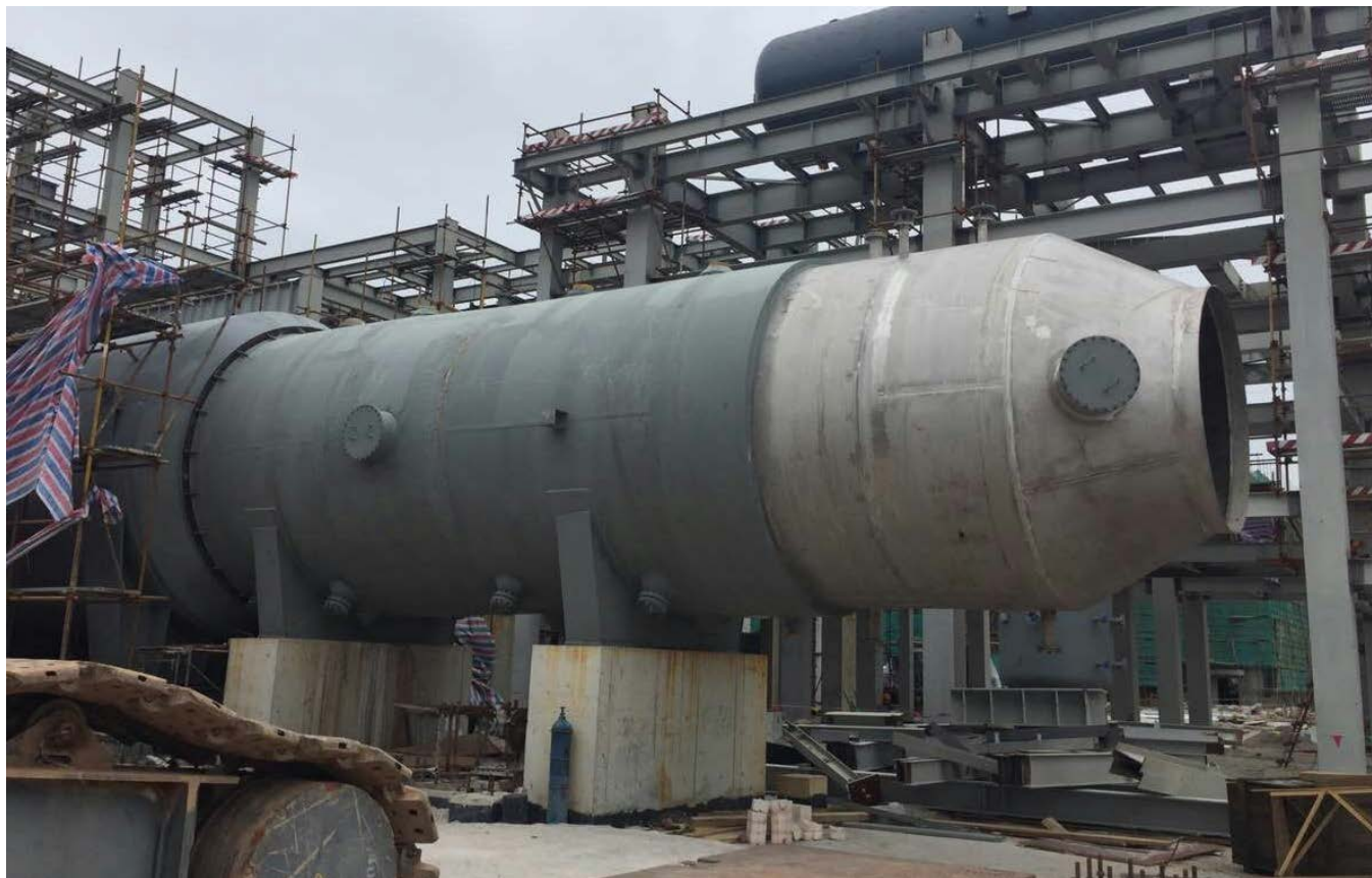
中海油惠炼二期30万吨/年硫化氢湿法制酸装置火管锅炉 (DN4200 6.8MPa)
