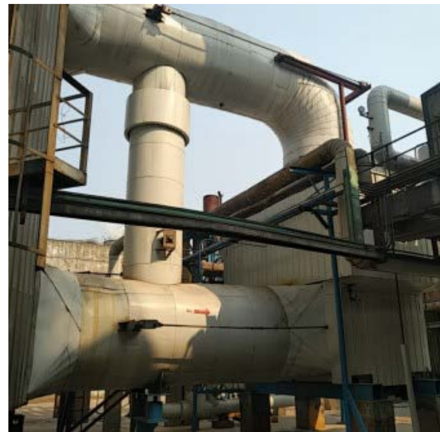
2019年6月份改造后运行近2年多，无 任何烟气泄漏，营造良好运行环境
