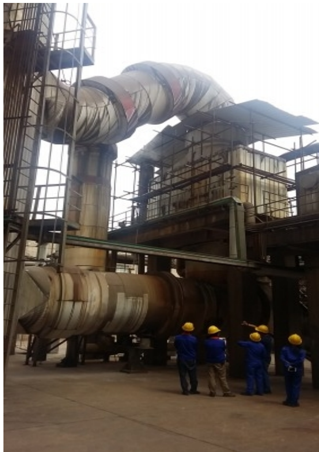
混凝土平台高过泄漏严重， 四周脚手架，经常堵漏
