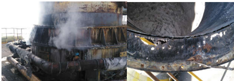
图1 合金逆喷管腐蚀状况
