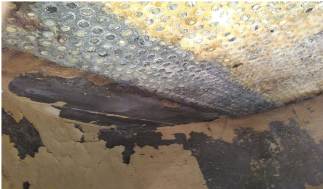
图 1 换热器串气实拍图
