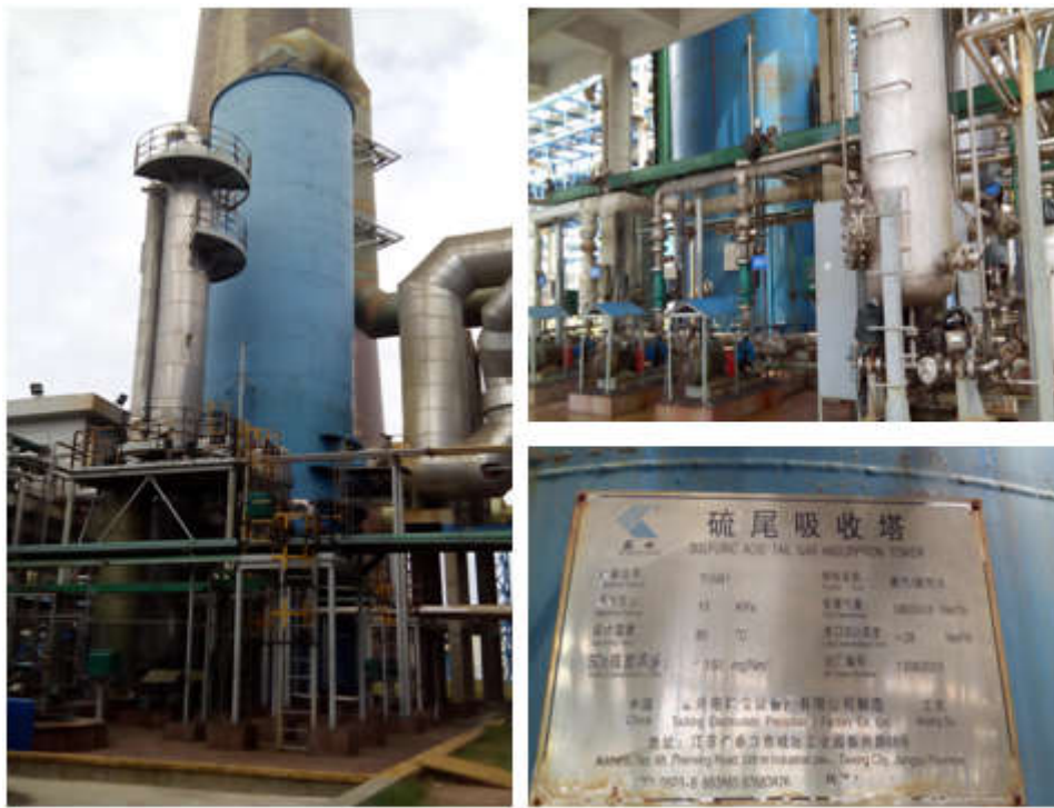
图 1 制酸尾气脱硫系统现场图
